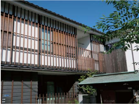
ルーバー（面格子）により修景された建築設備
