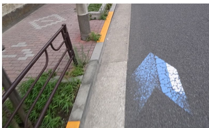
図 剥がれかけた舗装
