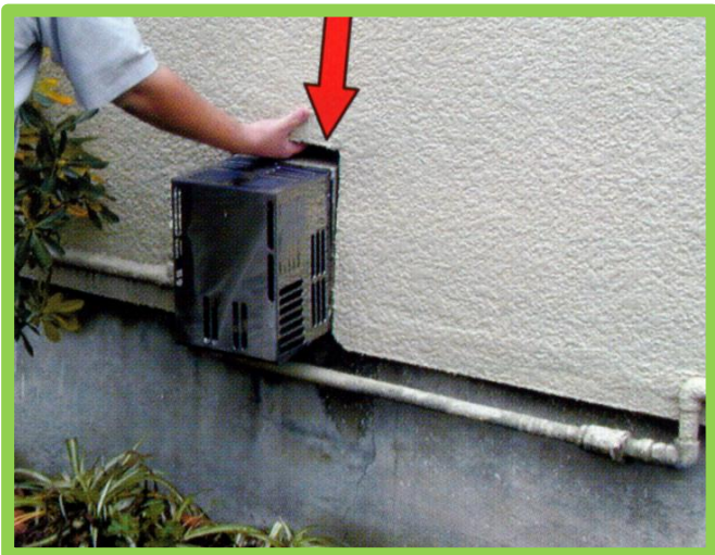
バランス釜排気口上部の すきまから侵入
