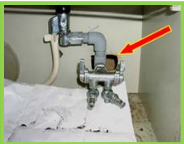
調理台のガス管の周囲から出入りします。
