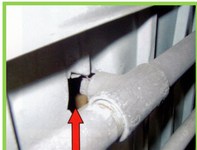
エアコンの配管周りからも出入りします。
