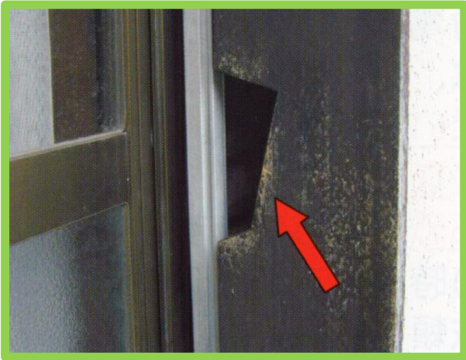
雨戸の戸袋から壁の内部へ侵入 (ねずみがかじった跡がある)
