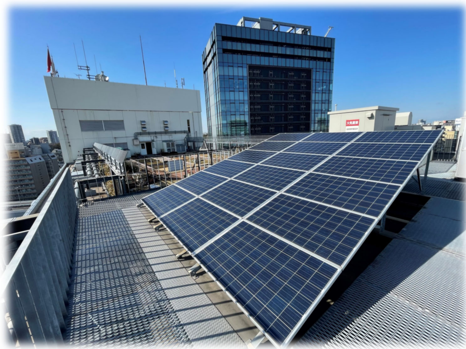
本庁舎屋上「太陽光発電設備」
