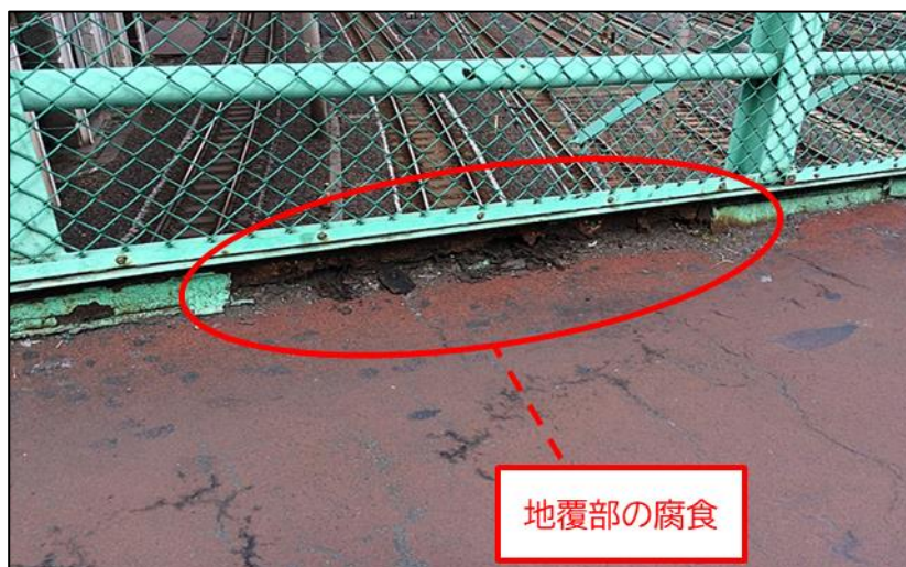
写真-1 凌雲橋歩道橋（北）の地覆部
